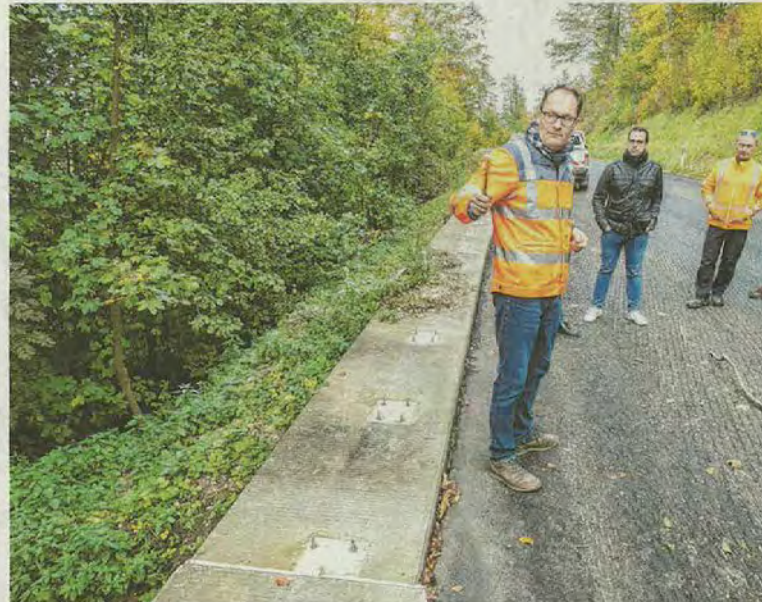
An dieser Stelle ist der Betongürtel abgesackt; Matthias Bauer vom Regierungspräsidium erläutert das Hangrutsch-Geschehen an der Gammelhäuser Steige. Foto: Staufenpress
