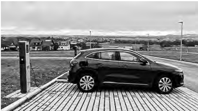
Die neuen Ladesäulen im Gebiet „Letten II“ sind freigegeben
