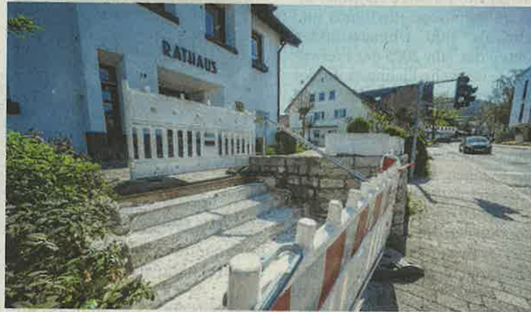
Die Rathaustreppe in Gammelshausen ist dringend sanierungsbedürftig und daher aktuell abgesperrt.
